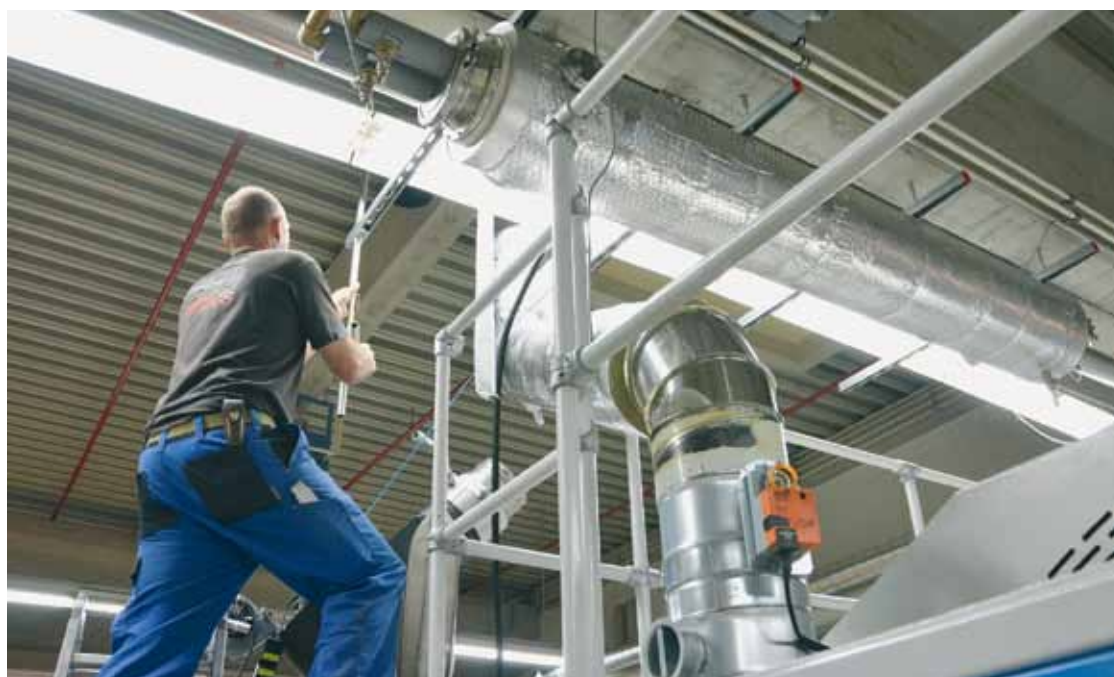
Erfolgreiche Montage: Die isolierten Rohre zur Zu- und Abführung des Warmwassers für die Wärmerückgewinnung
